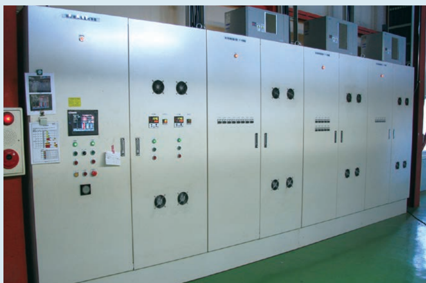
▲ハイブリッド乾燥炉制御盤
