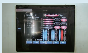
▲乾燥炉の制御盤モニター
