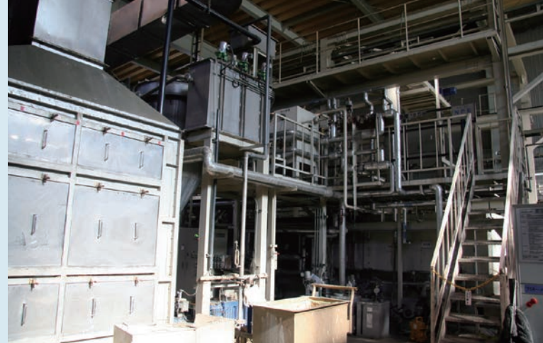
電着塗装設備 ▲
